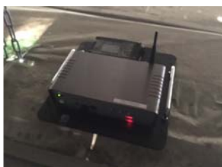
図11 設置したモジュール
